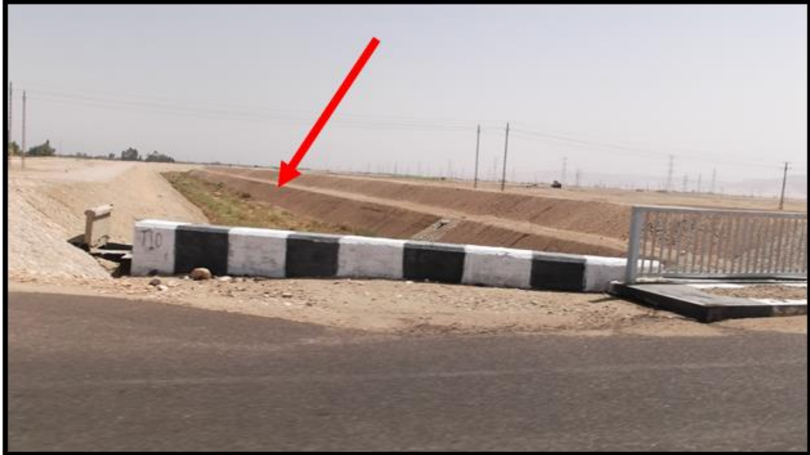
لوحة (١١) نهاية ترعة مص محطة رفع رقم (ب) بمشروع المراشدة- نموذجاً لعدم وصول مياه الري لنهايات الترع المصدر: الزيارة الميدانية يوم الاثنين الموافق ٢٠٢٠/٩/١٤
